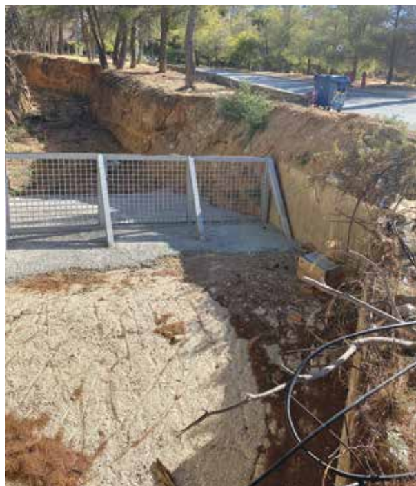
Μεταλλικό πλαίσιο συγκράτησης φερτών υλικών
